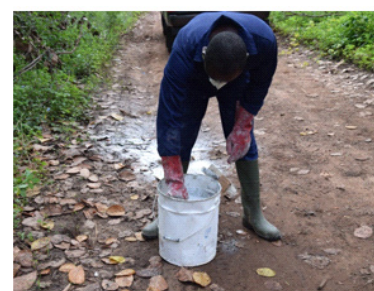
Figure 3 : homogénéisation du lait de chaux
